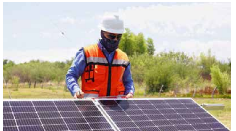
El gobernador Alfonso Durazo Montaña concluyó la primera etapa del programa social de Generación Solar Distribuida, que contempla la instalación de plantas solares fotovoltaicas en localidades de la sierra.
