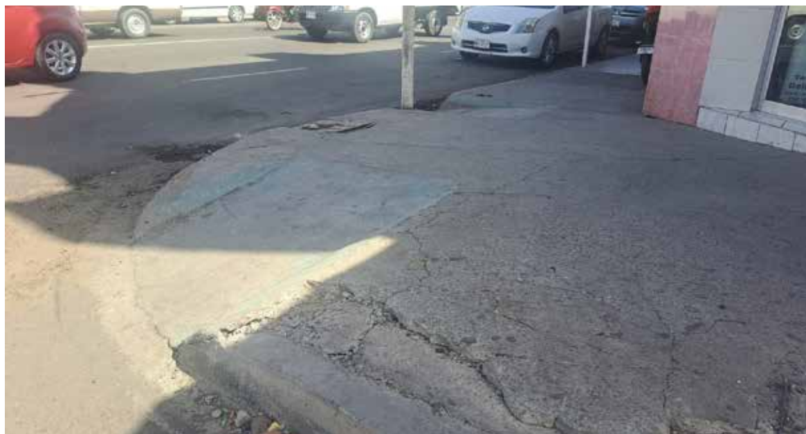
Pese a las reparaciones hechas en años pasados, las rampas presentan serias cuarteaduras, convirtiéndose en un peligro para quienes transitan por donde están instaladas.
