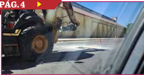
REPONEN TAPAS DE ALCANTARILLAS
