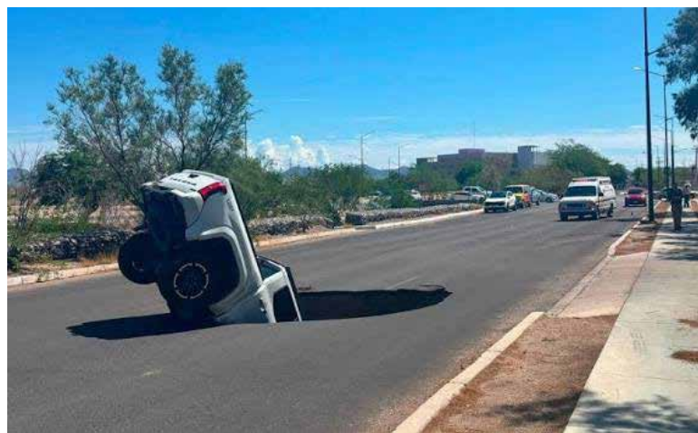
Infraestructura envejecida, origen del socavón que paralizó el Quintero Arce: AGUAH.
