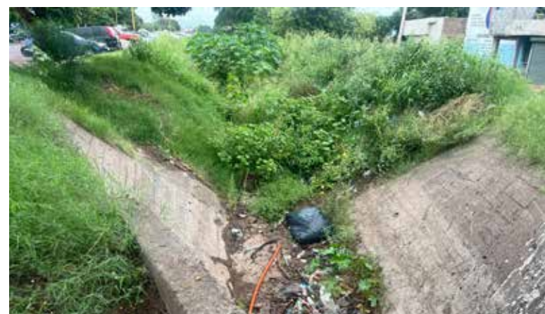
Convertido prácticamente en un tiradero a cielo abierto se encuentra un tramo del canal ubicado sobre la calle 300, entre Jalisco y Paseo Miravalle.
