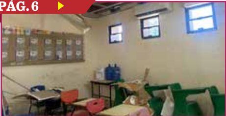
COLAPSAN TECHOS EN PRIMARIA DE LA URBI
