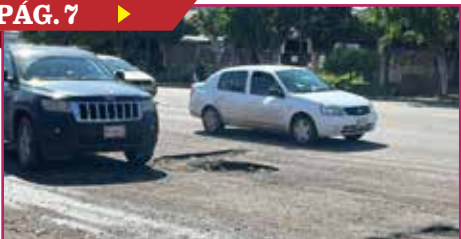
ORIGINAN RIESGOS BACHES POR LA 200
